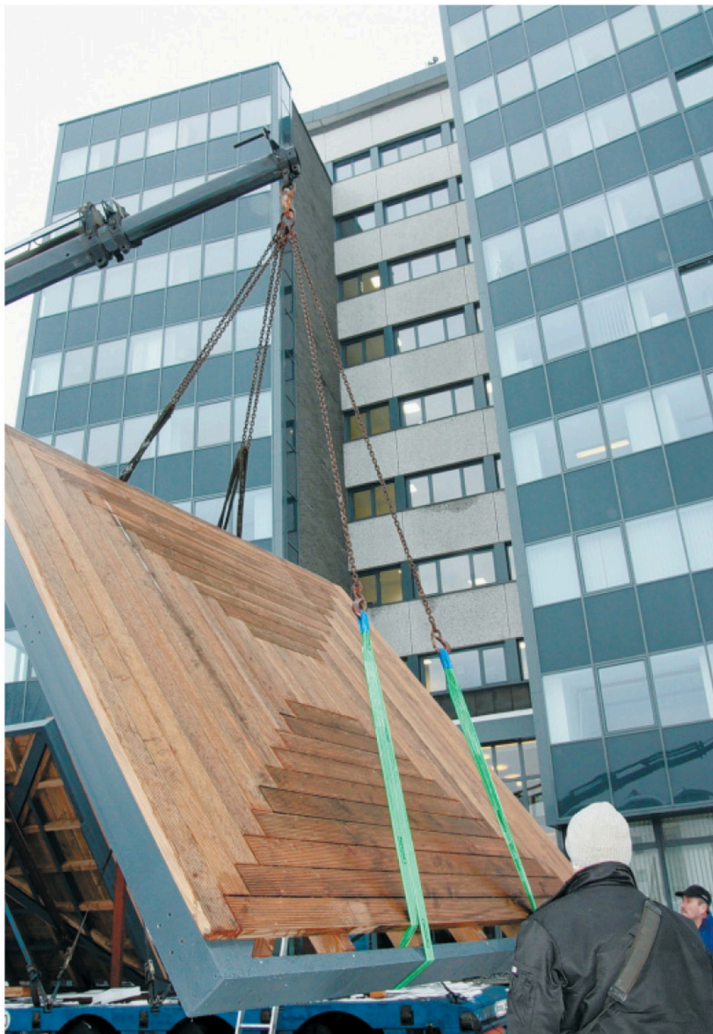
An vier Ketten schwebend: Eine der beiden Seeterrassen aus wetterbeständigem Douglasienholz wird vom Autokran hochgezogen. Er fährt sie anschließend auf dem provisorisch erweiterten Weg links am Sennestadthaus vorbei, wo sie in luftiger Höhe auf den beiden Eisenpfeilern angebracht werden. FOTOS: SILKE KRÖGER
